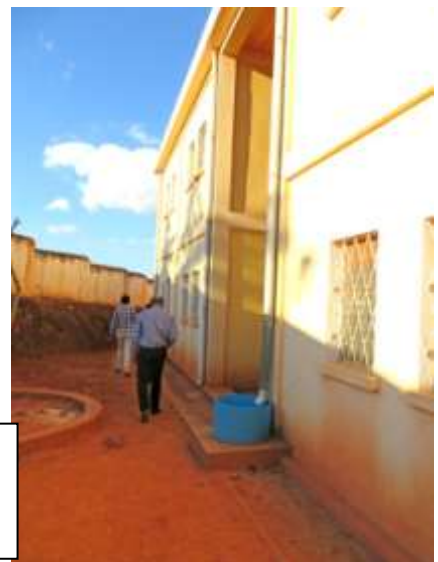
aménagement arrière lycée recueil eaux de pluie dans bidons bleus coupés, descentes gouttières prolongées
